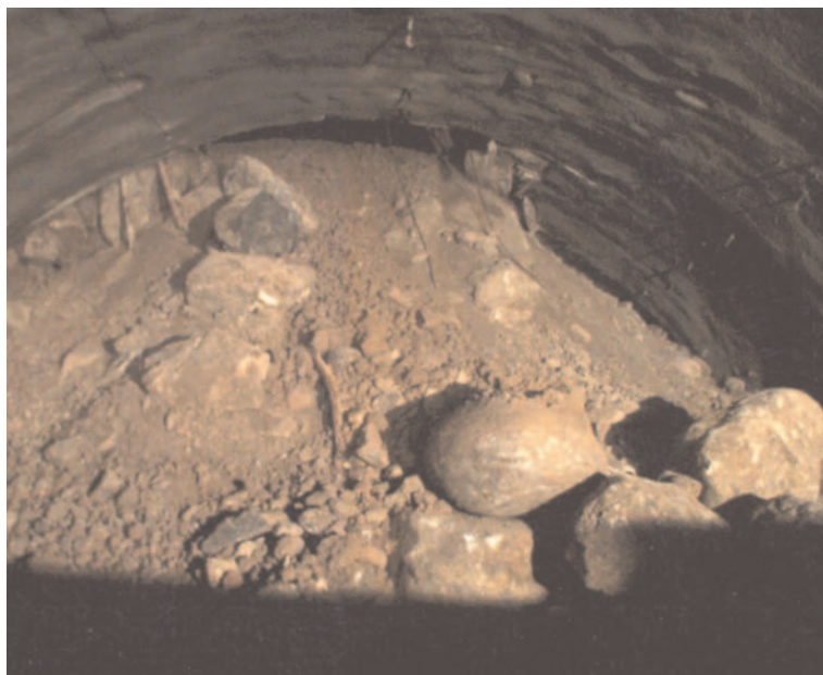
Fig. 16. Derrumbe lado mar.
